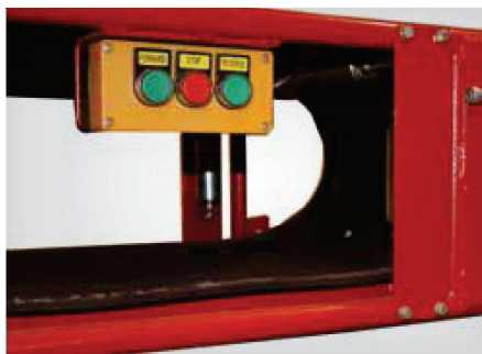
Boîte de contrôle secondaire au haut du convoyeur
