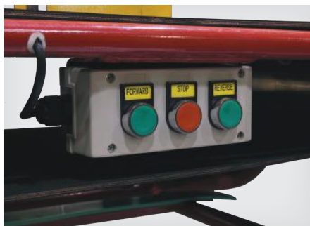
Boite de contrôle secondaire au haut du convoyeur
